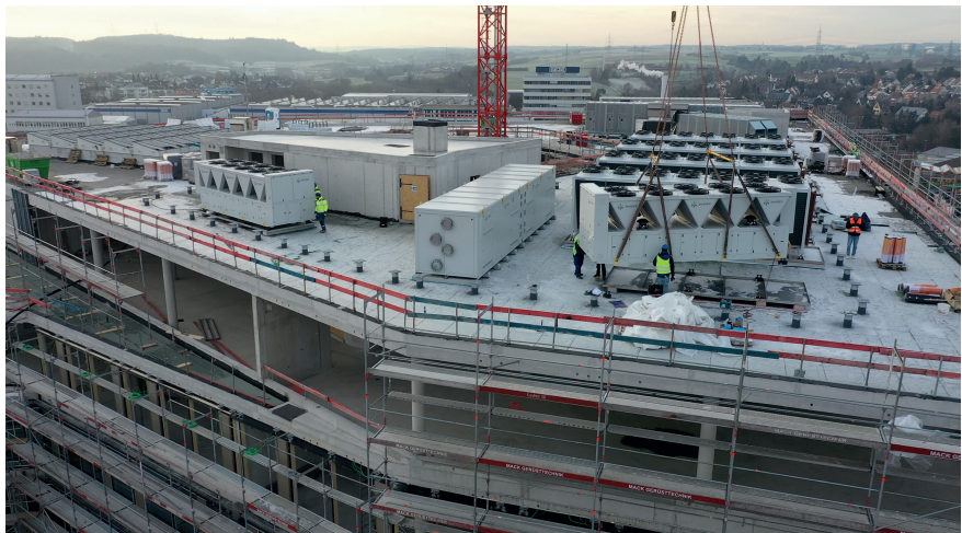
Heizen und Kühlen unter Einsatz von Propan als Kältemittel: Auf dem Dach des Neubaus in Leonberg wurden zwei Kaltwassersätze und zwei Wärmepumpen aufgestellt. Heizleistung: 3 502 kW, Kühlleistung: 1 032 kW. Foto: Skadec GmbH
